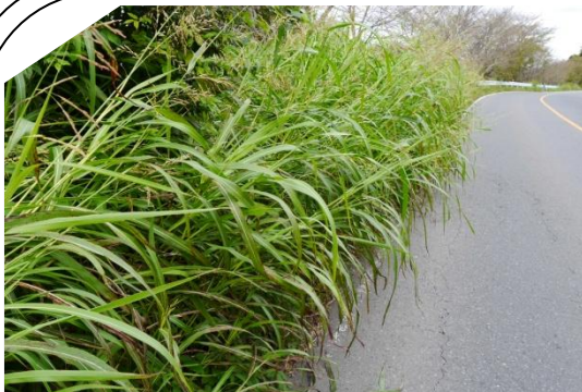
雑草が白線を越えて車道におおいかぶさっている (川島の堤防沿い)
