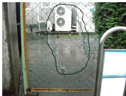
金網の破れ(黒い線で囲んだ部分)
