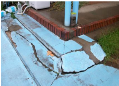
プール入り口のひび割れ
