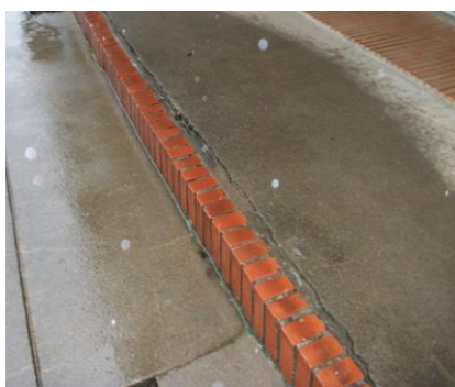
テラスのひび割れ
